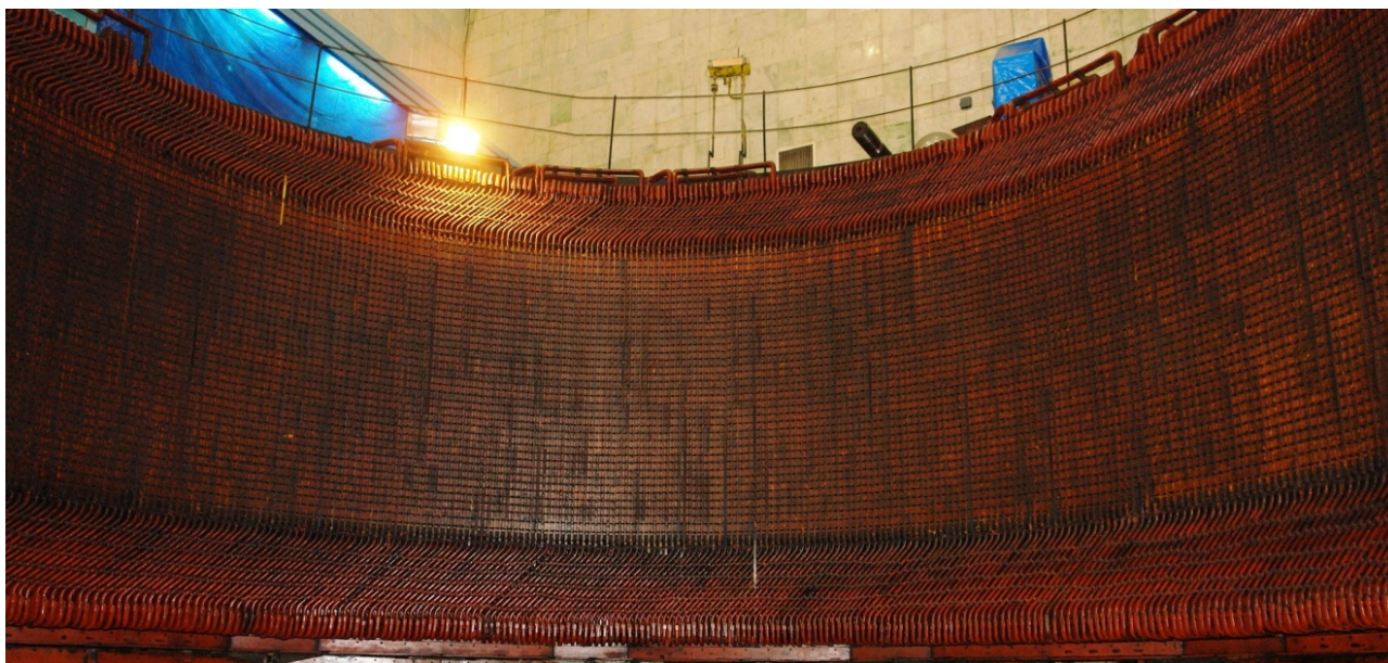
Рис. 1. Фрагмент стенки активной стали статора гидрогенератора
